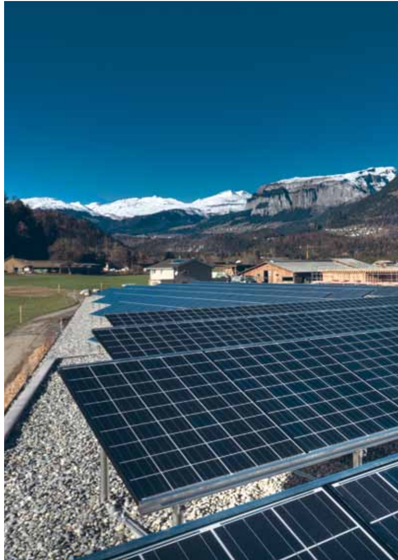
Fotovoltaikanlage Werkhof Crest Ault
